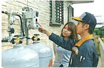
ガスメーターの操作方法などを確認
