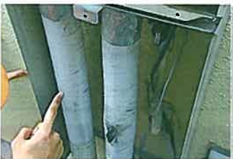
設備の不具合・水漏れなど確認
